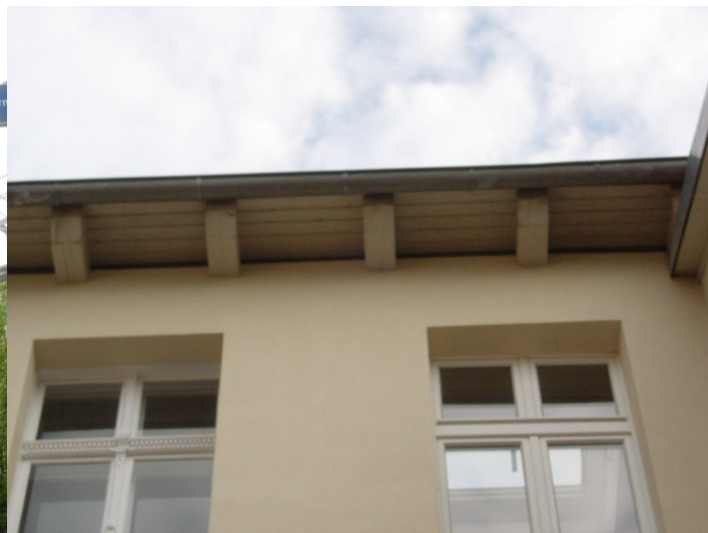
Foto 2: Hohlräume unter Dachvorsprung
