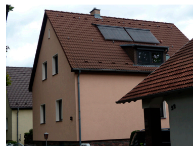
Solarthermieanlage in der Sternstraße
