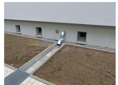
Das Niederschlagsfallrohr im Pilotblock ist in die Fassade integriert
