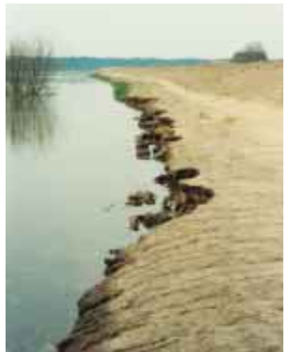
Bild 12: Auskolkungen durch Eis Elbdeich 1994
