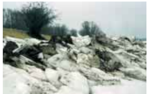
Bild 8: Böschungsschälungen durch Eis am Oderdeich (März 1994), die durch den Wachdienst rechtzeitig erkannt wurden
