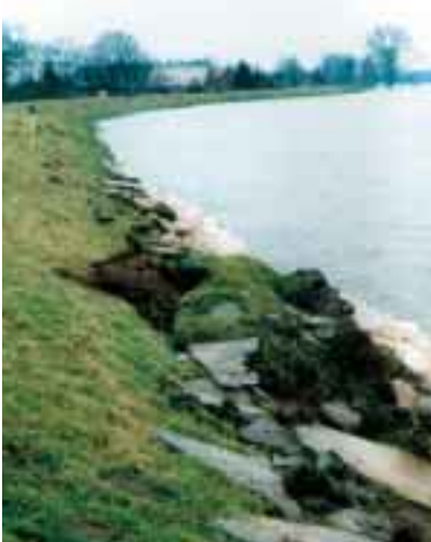
Bild 9: Böschungsschälung durch Eis Elbdeich Winter 2003
