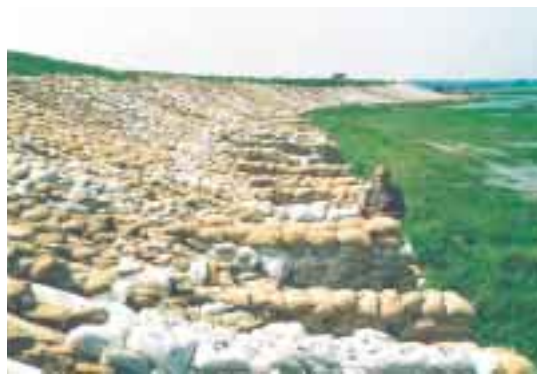
Bild 19: vorbeugende Sicherung des Elbdeiches am „Bösen Ort“ bei Wustrow (August 2002), Stützpfiler aus Sandsäcken
