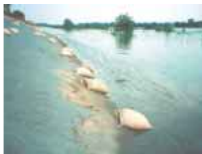
Bild 14: Aufgeschwommene Folie durch unzureichende Beschwerung (nur 1 Lage Sandsäcke)
