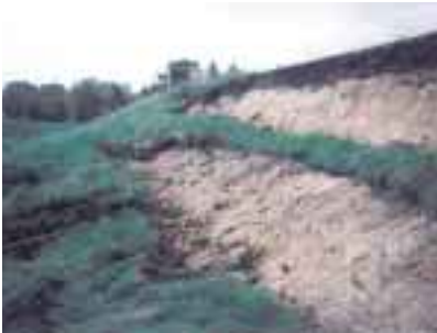
Bild 18: abgerutschte Böschung Oder-Spree-Kanal (1997) bei Eisenhüttenstadt
