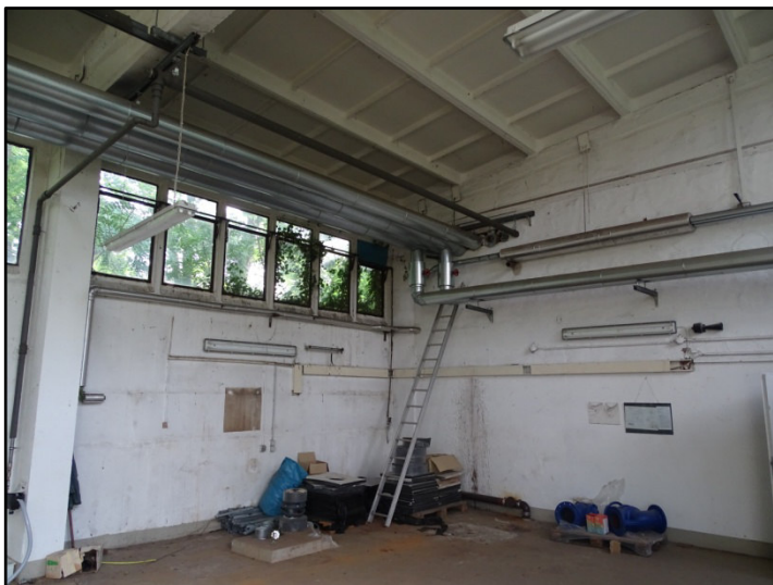
Abbildung 13: Innenbereich des Heizhauses
