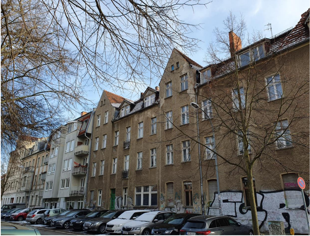
Abbildung 26: unsanierte, schadhafte Fassade
